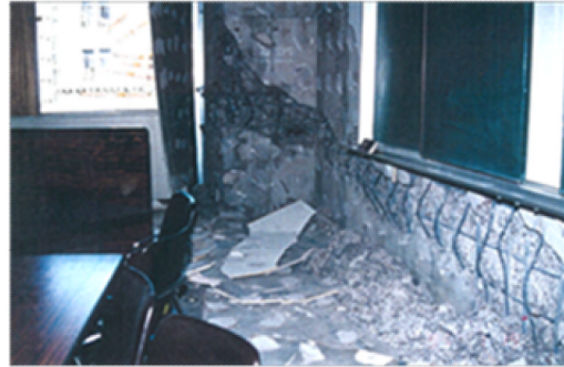
内部の被災状況
