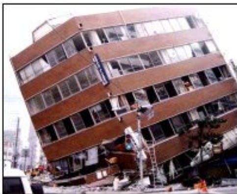
事務所ビル1, 2階の崩壊
