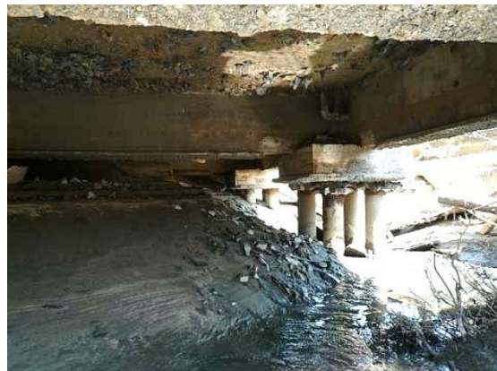
建物基礎が露出
