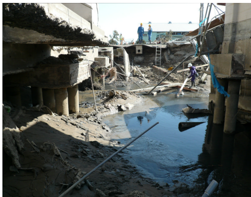
庁舎周囲の地盤流出
