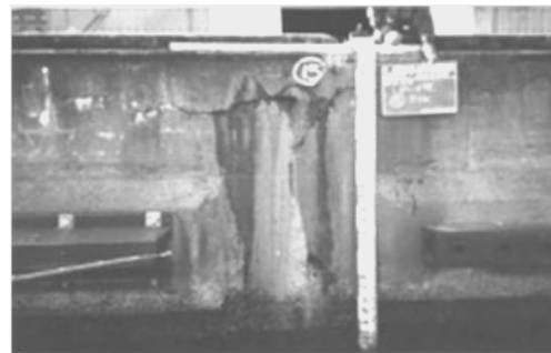
老朽化による岸壁の劣化 (コンクリートのひび割れ)
