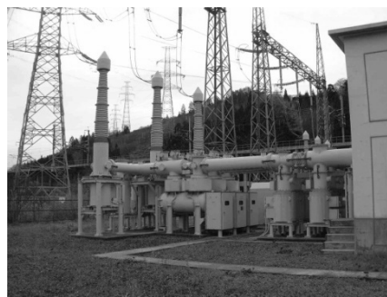
【変電所設備の一例】
