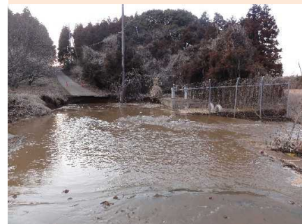
被災の状況（排泥工からの出水）
