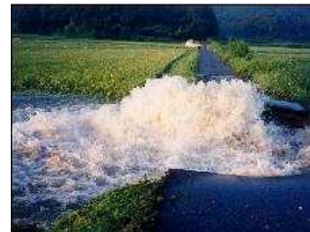
(出典) 水資源機構 HP 写真1-4-2 支線パイプラインからの出水
