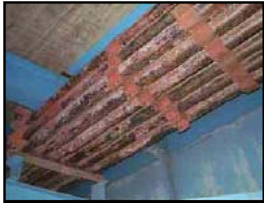
橋梁下面の添架物の腐食
