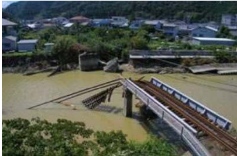
JR橋梁被災状況
