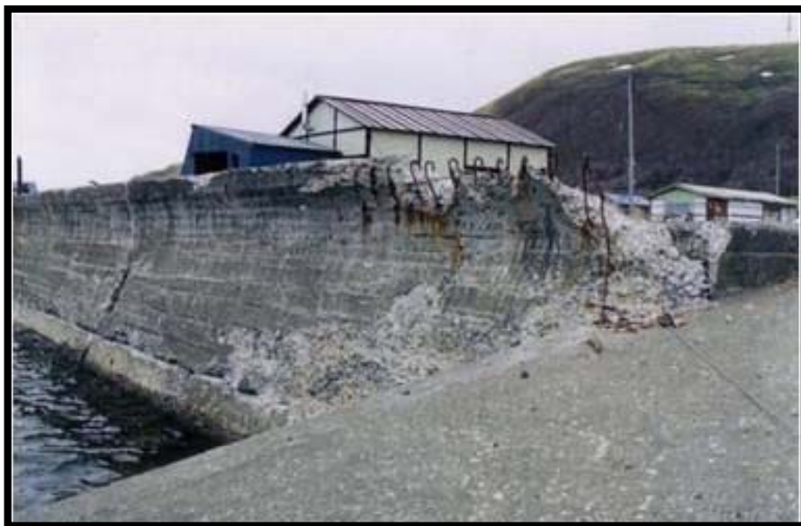
老朽化した海岸堤防
