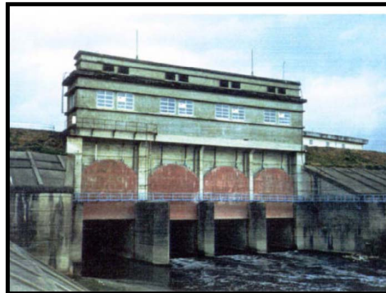
樋門の老朽化
