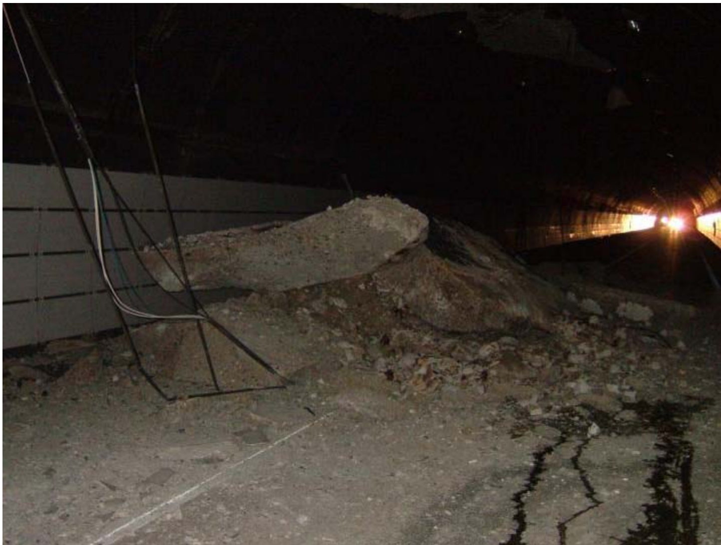
平成16年10月 新潟県中越地震（死者 68人 負傷者 4,805人） わなづ 和南津トンネル 内壁崩落状況
