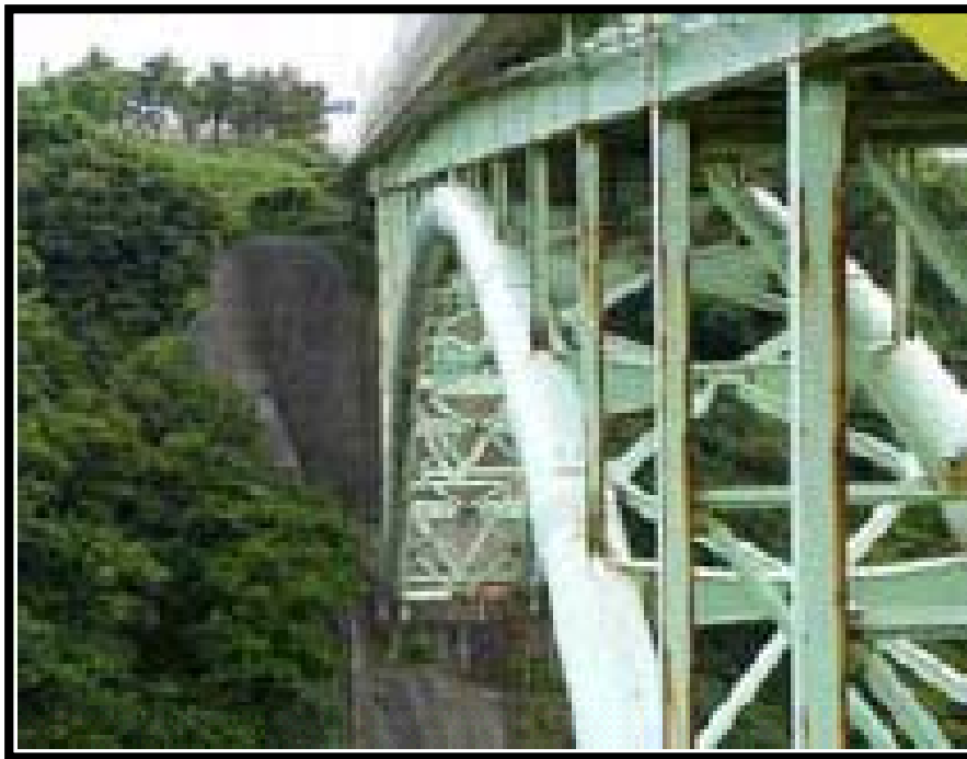
アーチ橋の腐食状況
