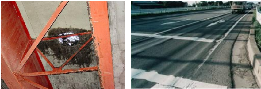
(橋梁の抜け落ち)
