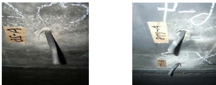
図3.1.2 落下せずにとどまっていた天頂部接着系ボルトの例
