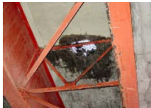
(橋梁の抜け落ち)
