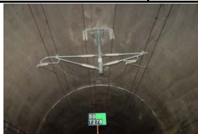
下束(架線を吊る金物)
