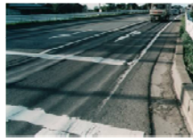
(舗装のわだち掘れ)
