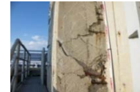
水門の門柱部のコンクリ剥離
