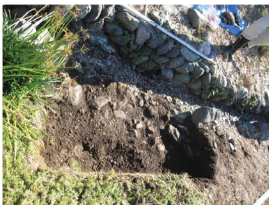
写真 32 補修箇所の石積みの後背を奥行き約 90cm、 約幅 2m、深さ約 40cm 掘削し、既存の 石積みの石を撤去
