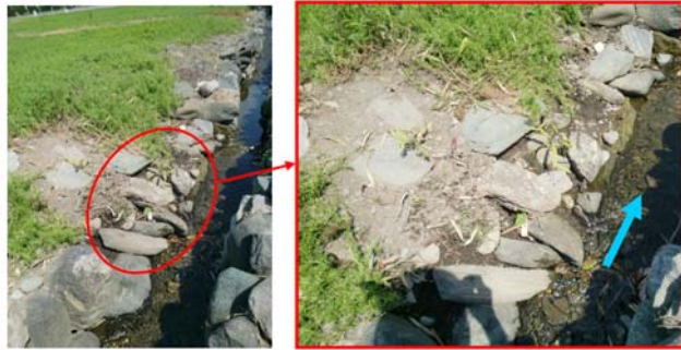
写真6 石積みの破損箇所の例
