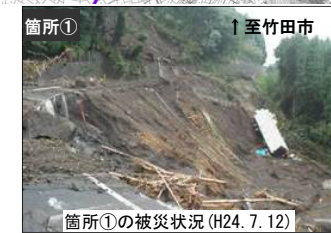
箇所①の被災状況(H24.7.12)
