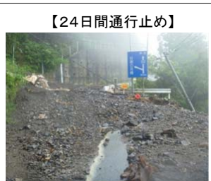
【写真①】国道168号崩落状況(H23.9)
