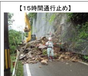
【写真②】国道168号崩落状況(H24.6)
