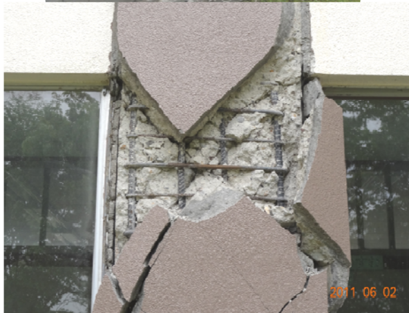
RC柱部材の被害例 (2011年東北大震災)
