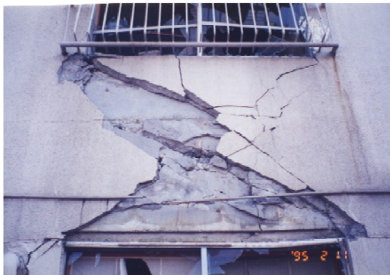
RC梁部材の被害例 (1995年阪神大震災)
