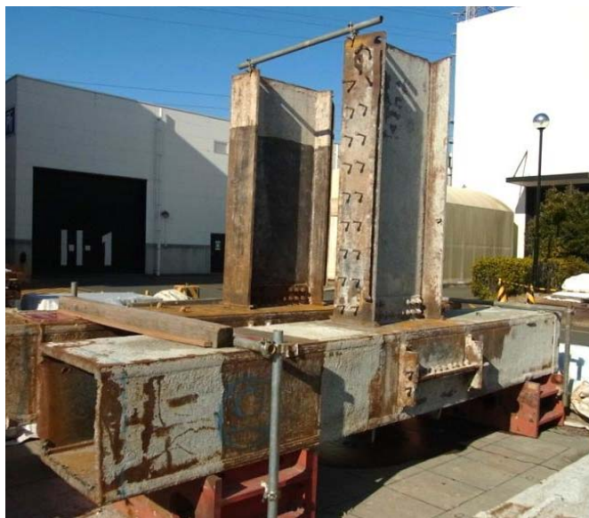
試験体切出状況
