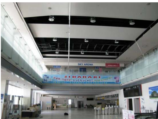
旅客施設における天井の脱落
