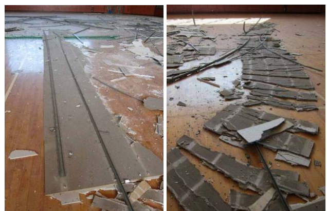
脱落した天井部材
