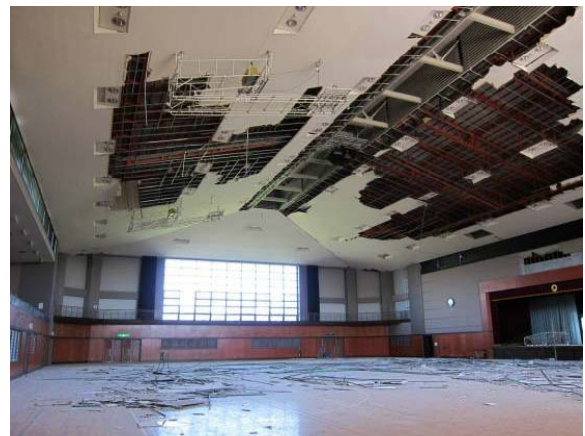
体育館における天井の脱落
