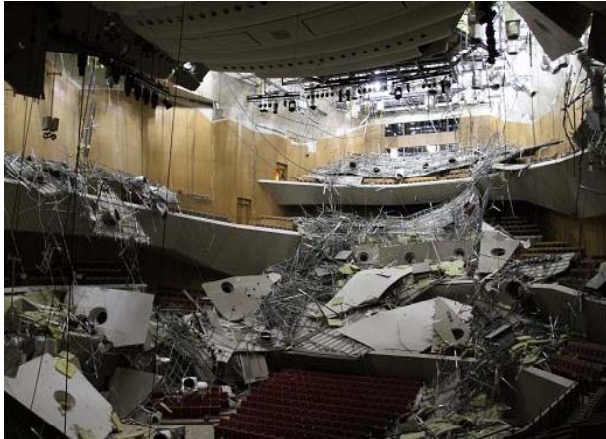
音楽ホールにおける天井の脱落
