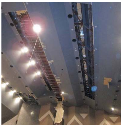
ホールにおける天井の脱落
