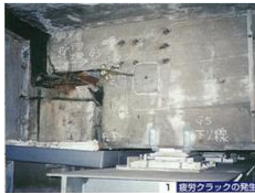
部分的に経年劣化
