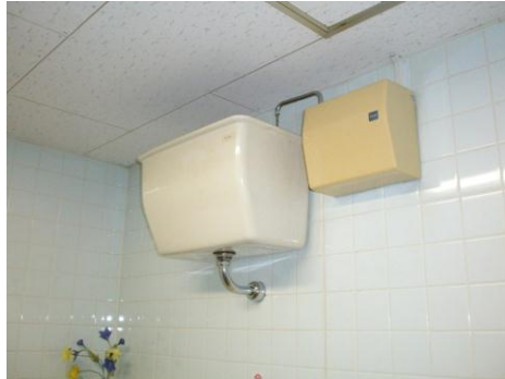
■トイレの節水タンク（旅客ビル）
