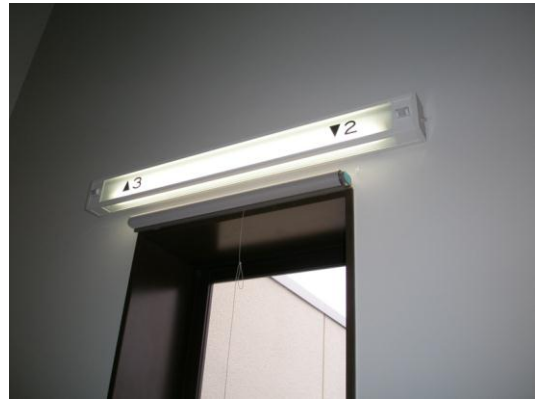
■人感センサーを利用した照明の自動点灯
