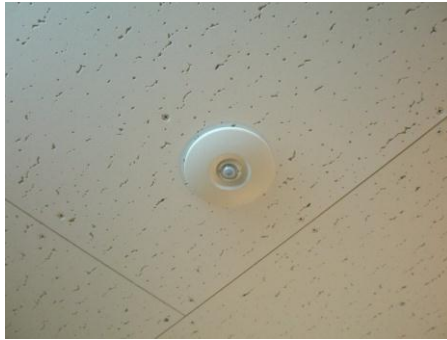
■人感センサーを利用した照明の自動点灯
