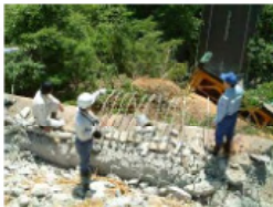
被災状況調査(現地調査)
