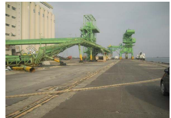
アンローダー倒壊(写真:仙台塩釜港 (仙台港区)国土交通省、防災部会)
