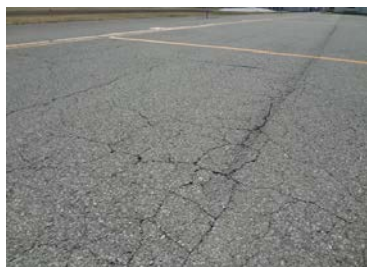
(老朽化した基本施設舗装)
