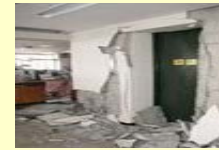
(※)東日本大震災後のA市役所の損傷状況
