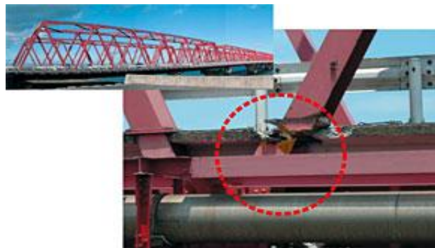
損傷(鋼材破断)の実例 (国道23号木曾川大橋)
