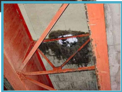
橋梁のコンクリート床版の損傷事例 (国道4号白河橋)
