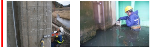
門柱の劣化調査
