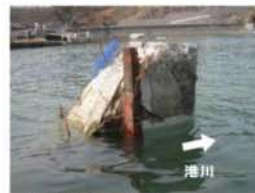
中央部堰柱の残存状況 (下流側が残存)
