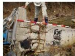
操作台と門柱上部 (激しい上向き力により操作台基部が破壊している)
