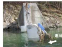
残された堰柱の破断状況と 山付けの防潮堤
