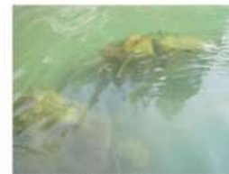
水面下に残る堰柱破断面
