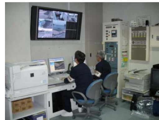
写真: 遠隔操作監視場所<気仙沼消防署>
