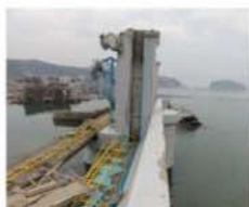
管理橋等が上流部へ倒伏
