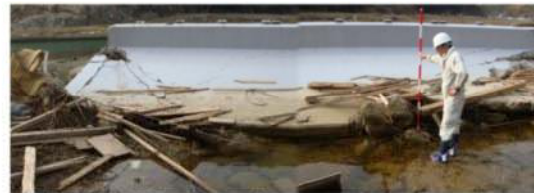
破壊され流出した門柱及びカーテンウォール
