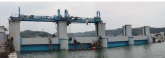
全景（下流面） 門柱上部の設備関係が損壊、流出、土木本体は大きな損傷なし
