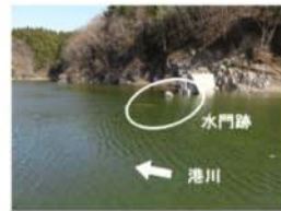
水門破壊後の状況 右岸の防潮堤のみ残存
