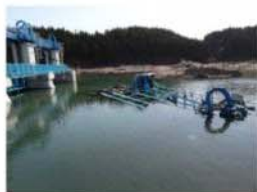
流出した巻上げ設備類と扉体
