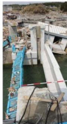
扉体が流出した1径間部
