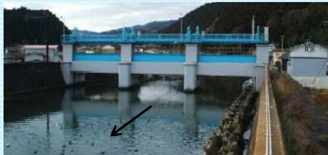
耐震対策・高速化・遠隔操作化実施後
