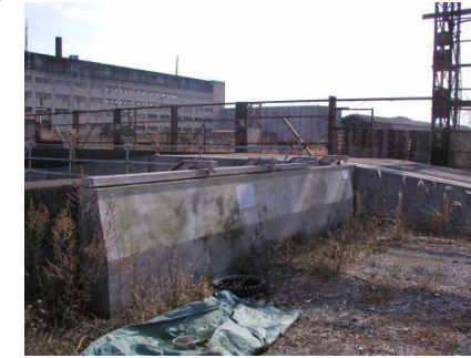
車の利用のある陸閘は廃止し、通行可能なスロープを設置した事例(種崎地区)
