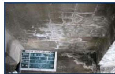
床版ひびわれ
