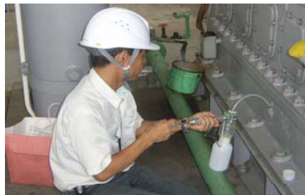
排水機場等機械設備の潤滑油分析による劣化診断
