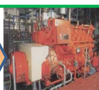
ガス発電施設
