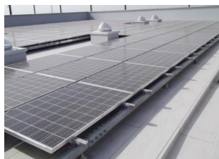
<太陽光発電設備>
