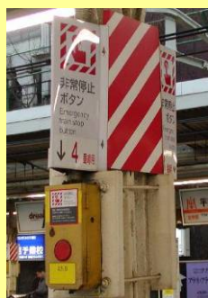
非常停止押しボタン
