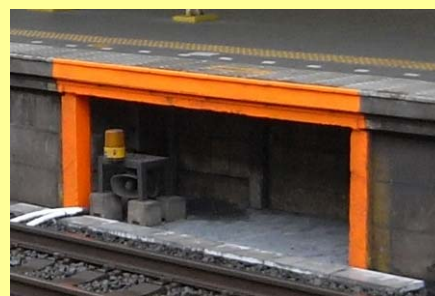
ホーム下の待避スペース
