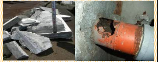
(左)落下したコンクリート (右)劣化による配管破損
