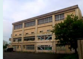
耐震化されたものの、老朽化による機能の劣化が著しい
