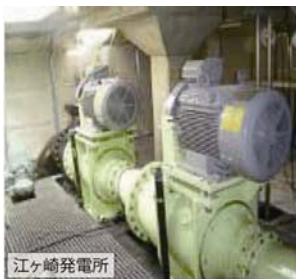
上水道での 小水力発電 事例
