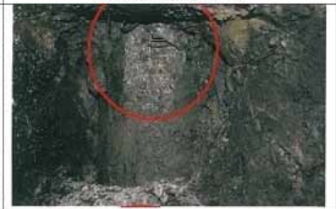
杭の損傷 (No. 3)
