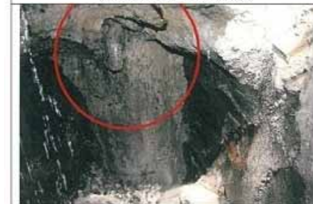
杭の損傷 (No. 2)
