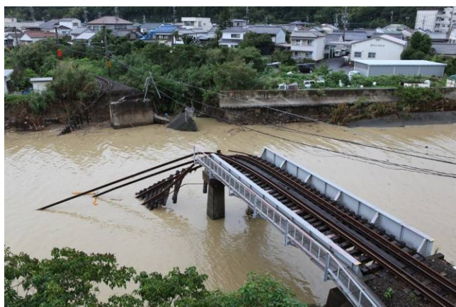
台風 12 号による被害状況
