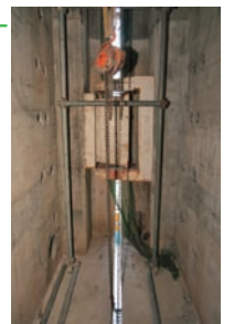
橋の中央ヒンジ部。PCケーブル工事終了後、コンクリートを打設し、橋の連結化を図る。
