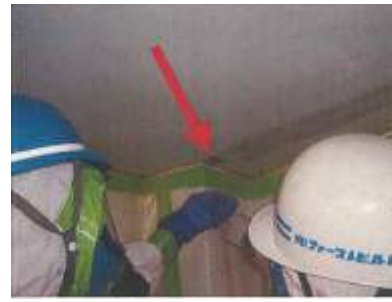
写真5 天井ボードに貫通孔あり
