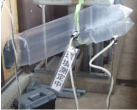
負圧除塵装置排気口前
