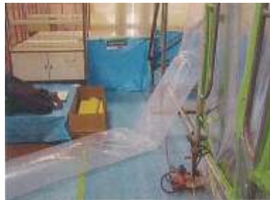
写真6 負圧装置ダクト中間部（曲がり部が多い）
