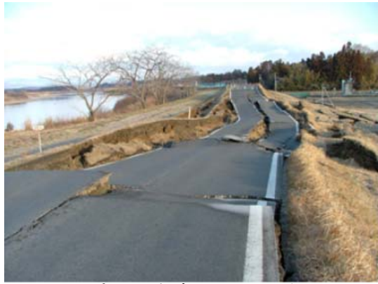
阿武隈川右岸 22.0k 付近 (角田市坂津田地先) ※地震による堤防沈下
