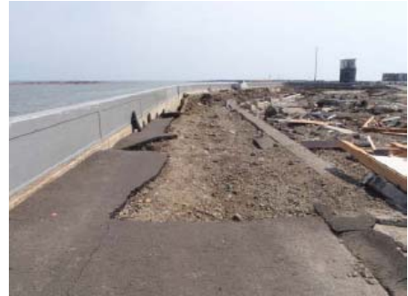
名取川右岸 0.2k 付近 (名取市関上地先) ※津波により堤内地侵食
