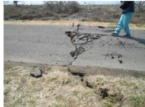
名取川左岸 2.9k 付近 (仙台市若林区今泉地先) ※地震により横断クラック発生
