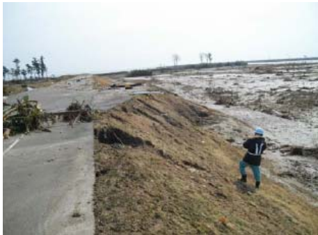
名取川左岸 0.3k 付近 (仙台市若林区日辺地先) ※津波により堤防法面侵食
