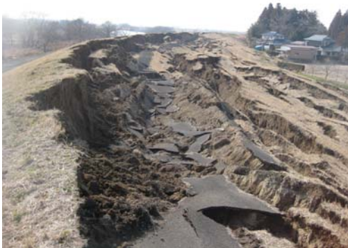
鳴瀬川左岸 30.3k 付近 (大崎市古川下中ノ目地先) ※地震により縦断クラック発生
