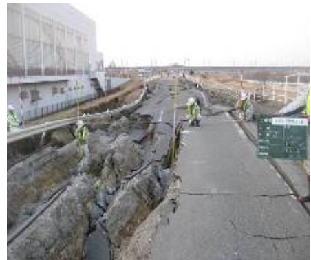
江合川右岸 26.6k 付近 (大崎市古川福沼地先) ※地震により縦断クラック発生
