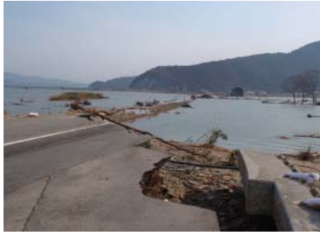
北上川右岸 4.0k 付近 (石巻市針岡地先) ※津波により堤防が流出
