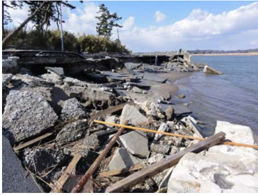
鳴瀬川右岸 0.0k 付近 (東松島市野蒜地先) ※津波により堤防が流出
