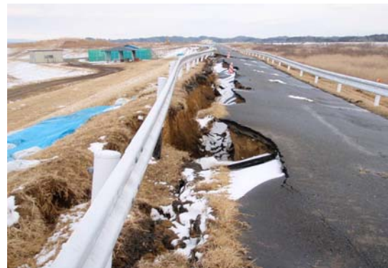
吉田川左岸 14.7k 付近 (大崎市鹿島台大迫地先) ※地震により縦断クラック発生
