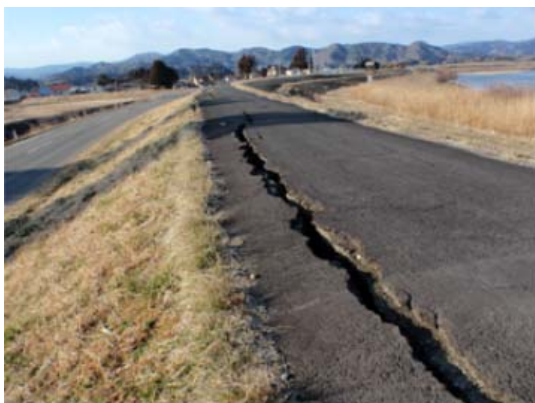
阿武隈川右岸 33.0k 付近 (丸森町小齊地先) ※地震による堤防亀裂
