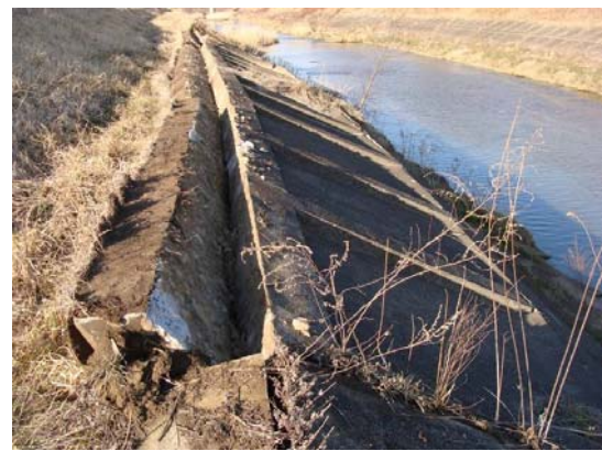
阿武隈川右岸 61.0k 付近 (東根川地先) ※地震による護岸破壊
