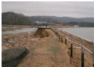
津波により堤防が被災
