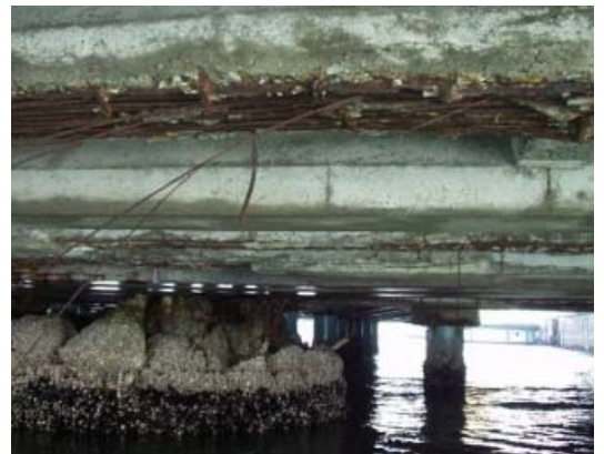
◀劣化や変状が顕在化した施設の増加▶
