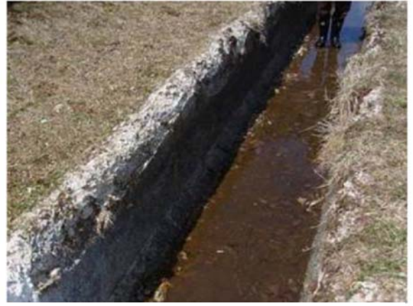
＜凍害によるコンクリート水路の劣化＞
