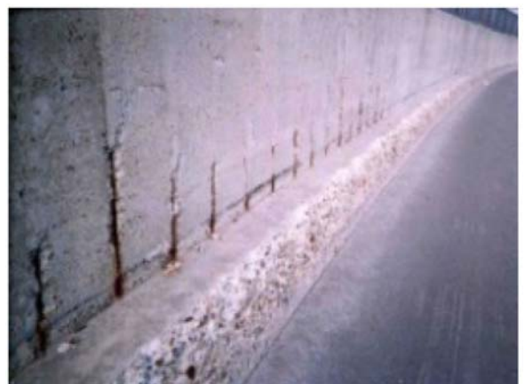
鉄筋露出とスケーリングが起きている コンクリート構造物
