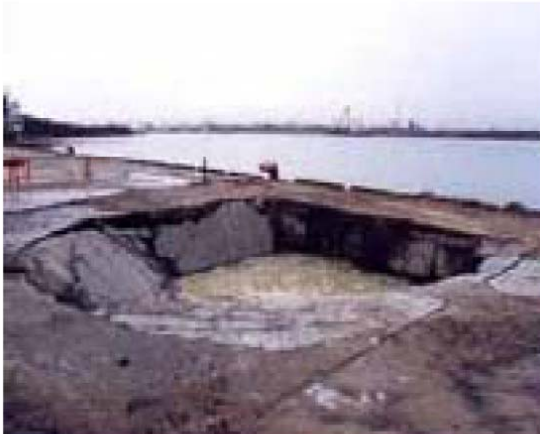
＜構造物内部の空洞化による陥没＞
