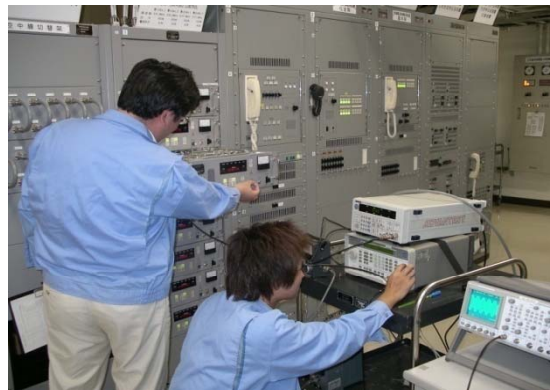
航空保安無線施設の点検
