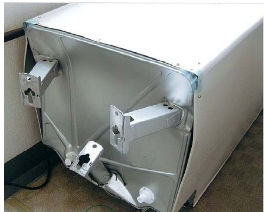
転倒した電気温水器の貯湯タンクの状況 （出典：国民生活センター）
