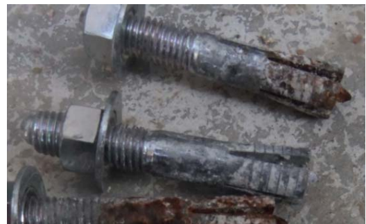
転倒後のアンカーボルト（出典：国民生活センター）
