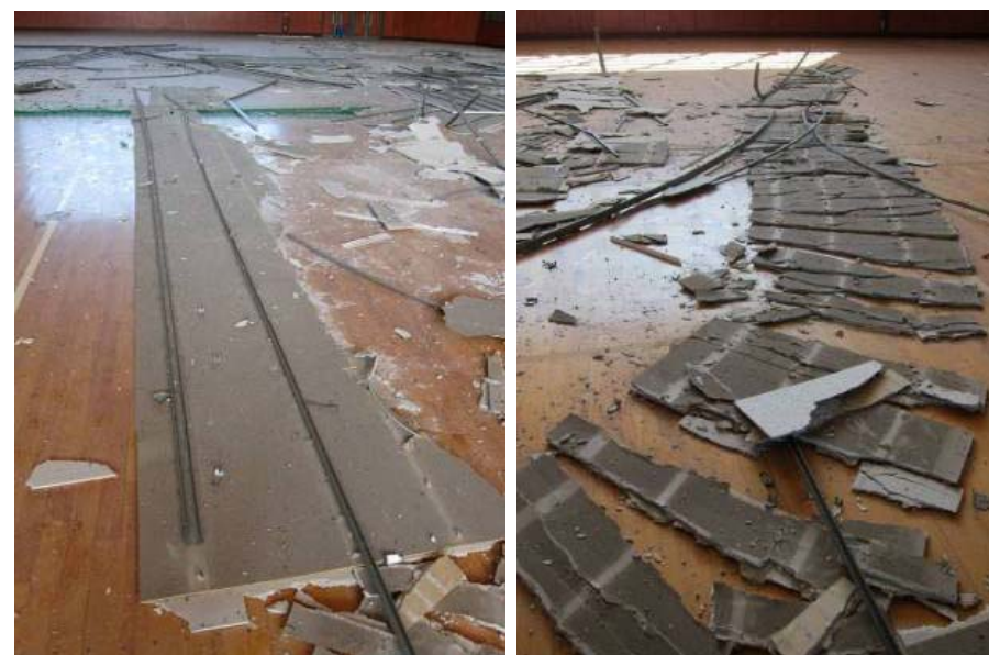
脱落した天井部材
