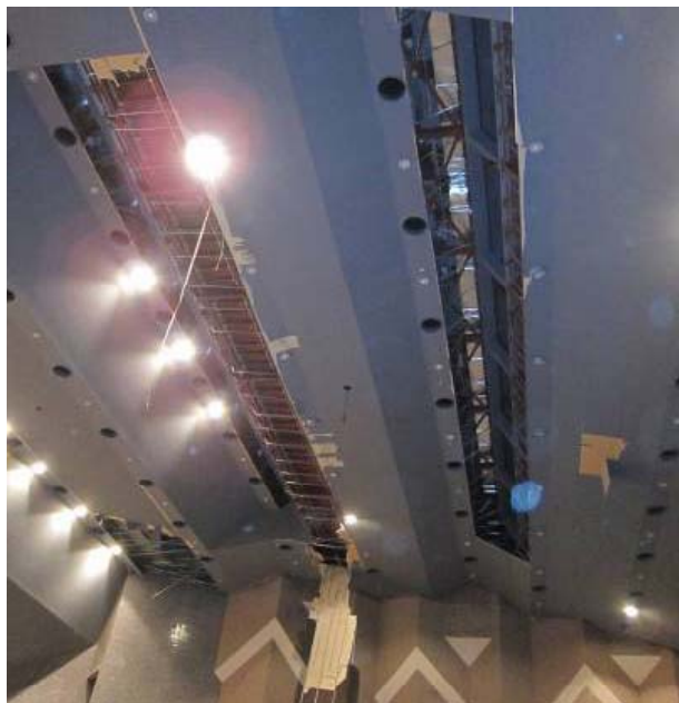
ホールにおける天井の脱落
