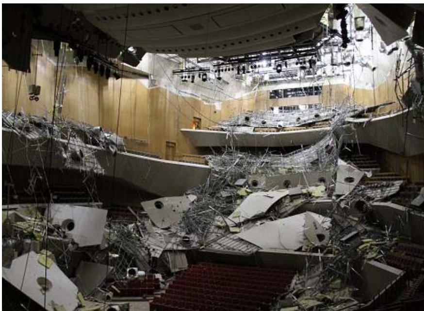
音楽ホールにおける天井の脱落
