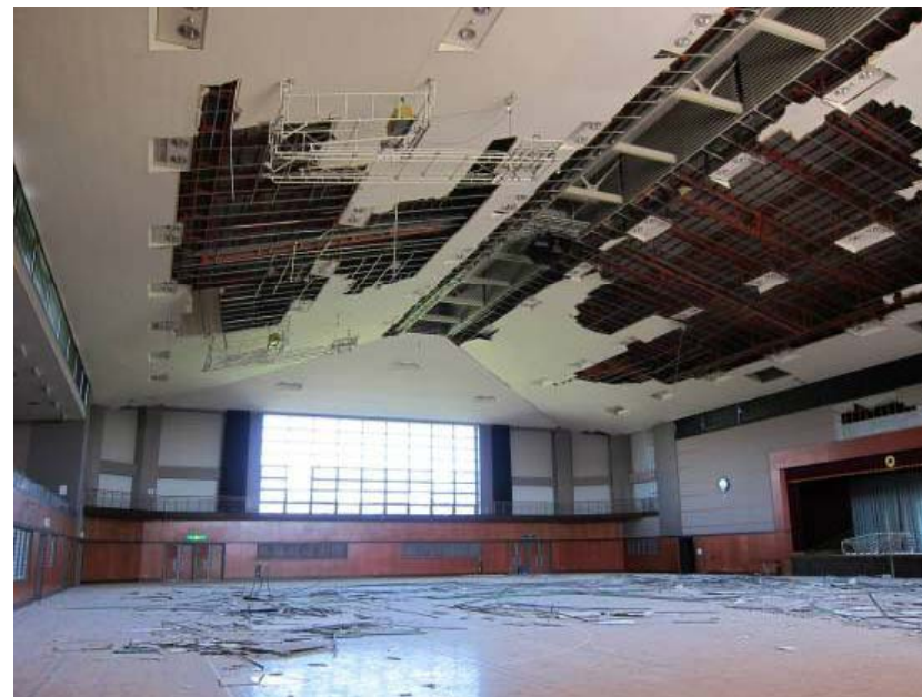
体育館における天井の脱落
