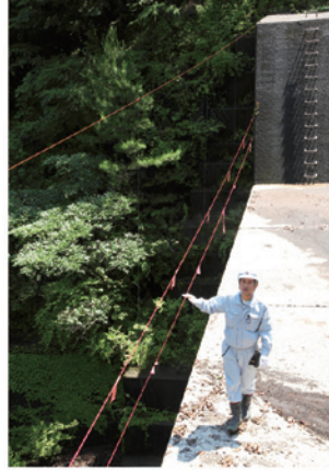
中央に見える2本の線が砂防堰堤に設置している土石流センサー。土石流が通過する際にこの線が切れ、自動で関係者にメールが配信される仕組みになっている。
