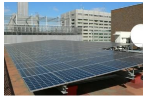
太陽光発電システム
