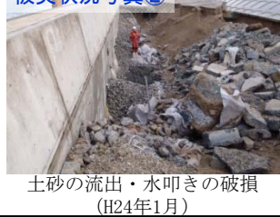
被災状況写真②
