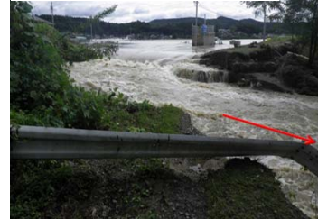
写真① 堤防の決壊箇所
