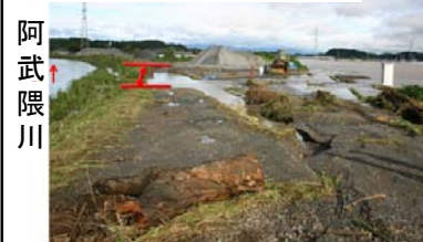
写真② 堤防の決壊箇所
