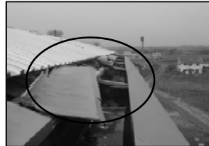
暴風により屋根が捲れあがった公園内の体育館
