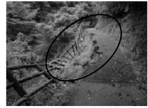
法面とともに園路も崩壊
