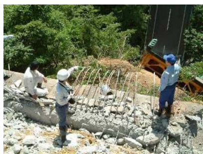
被災状況調査(現地調査)
