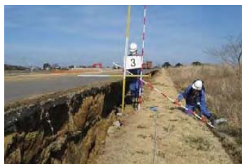
河川被災状況の調査
