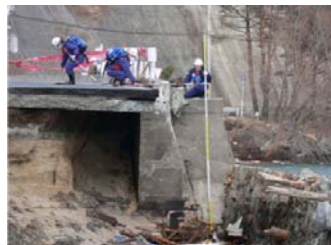
道路被災状況の調査
