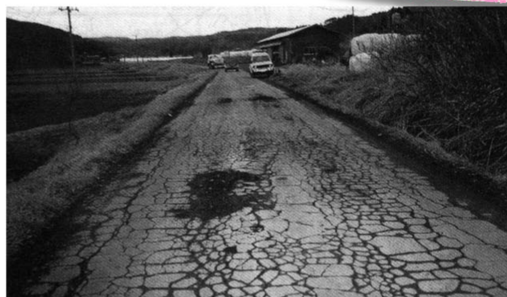
アスファルト舗装面にできた亀甲状のひび割れと、舗装が剥がれてできた穴。
