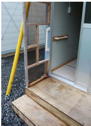
事例1: 玄関内外の手すり
