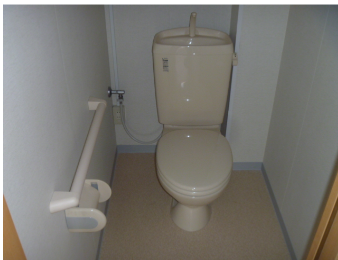
事例2: トイレの手すり
