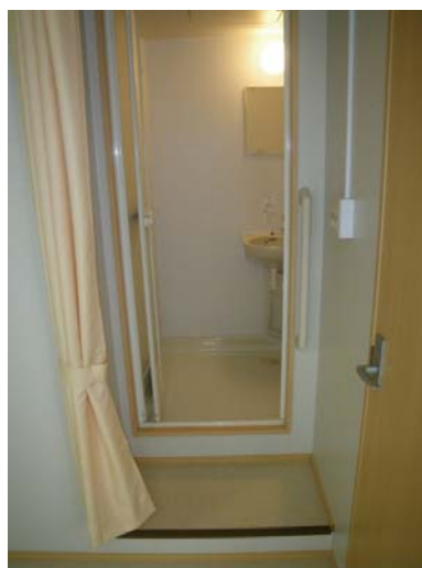
事例4: 浴室前の段差
