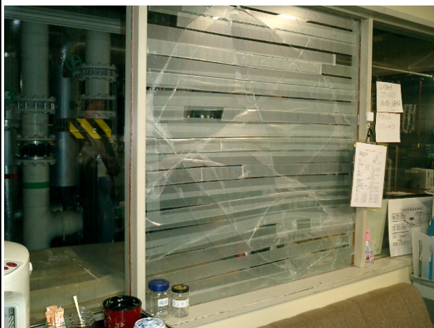
写真5 地下2階ガラス破損
