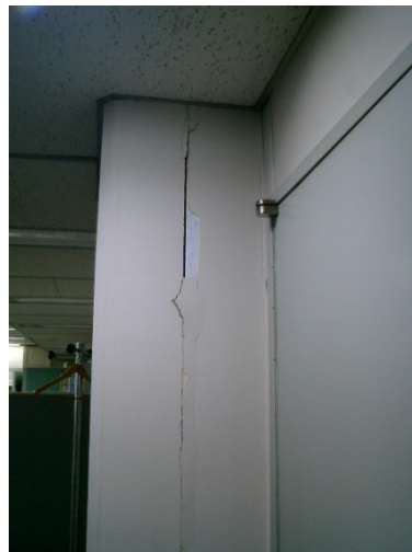
写真2 各階柱仕上げボードクラック
