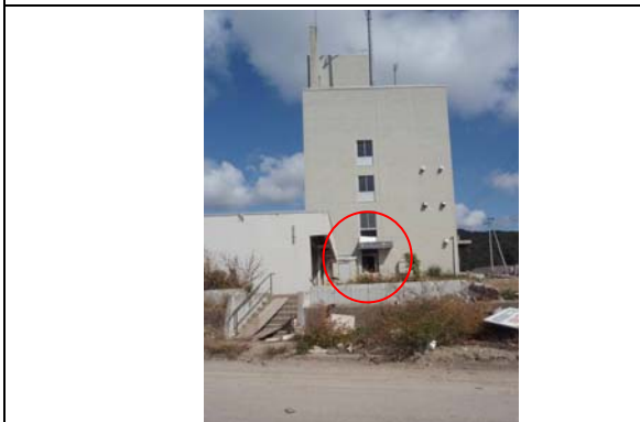
写真5 鉄骨庇のとれたエントランス
