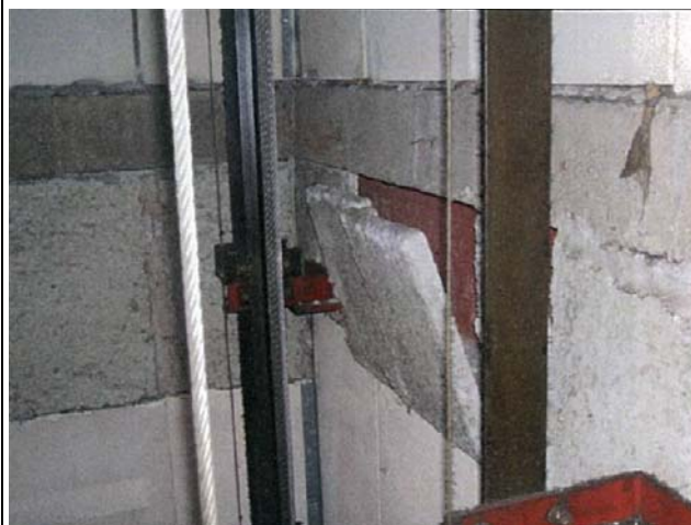
写真6 エレベータシャフト内耐火パネルの剥離・落下
