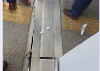
▲エキスパンション ジョイントの被害
