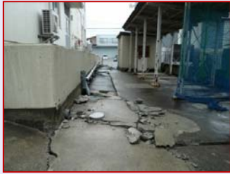
▲液状化による 地盤沈下
