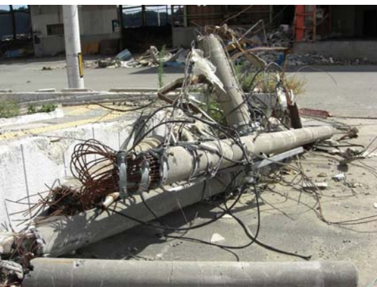
①停電の一因と考えられる引き込み柱の倒壊
