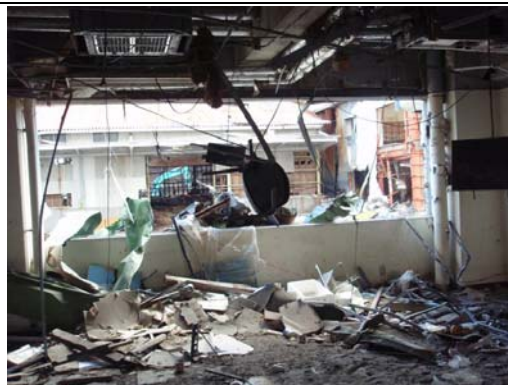
写真2 1F：津波被害を受け、壊滅
