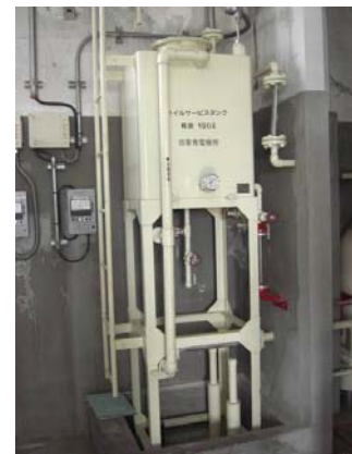
②自家発電機のサービスタンク (190ℓ) 枯渇し給電停止となったと思われる
