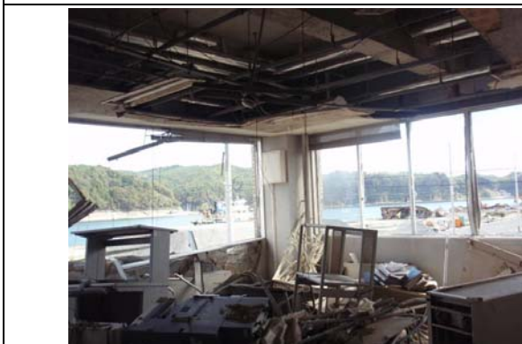
写真3 2F：津波被害を受け、壊滅
