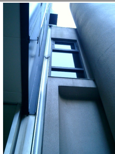
写真4 外部 EXP-J の変形・漏水
