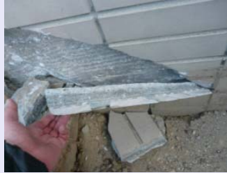
▲外壁タイル等の 仕上げ材の落下
