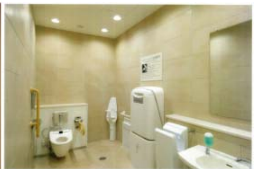
多機能トイレ：背もたれ一体型のオストメイト水洗、着替え台、おむつ替えシート、ベビーチェアを設置。
