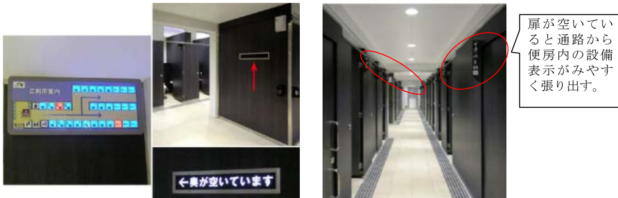
左：入口に設置した利用案内の表示で、大便器ブースの混雑状況を確認できる 右：手前が使用中の場合、壁の表示板が点灯し、奥の大便器ブースへ誘導
