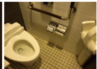
一般ブース：手すりとベビーチェアが設置されている。
