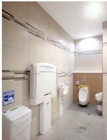
女性トイレ内にキッズコーナーを設け、幼児用小便器、おむつ替えシートを設置
