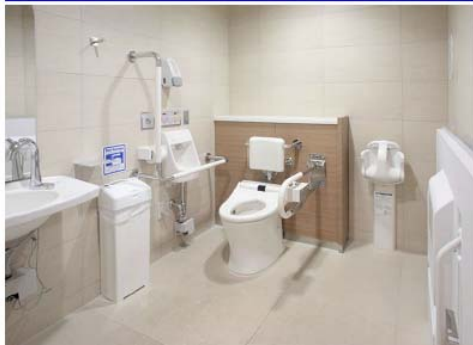
多機能トイレ： 車いす使用者が利用できる広さに、大型ベッド、ベビーチェア、着替え台を設置
