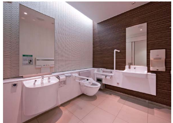
すっきりとしたデザインの多機能トイレ 汚物流しと大きめの鏡が設置されている
