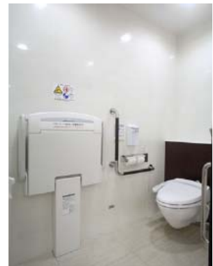
男女トイレ内に広めのトイレを設け、おむつ替えシート、着替え台、ベビーチェアを設置
