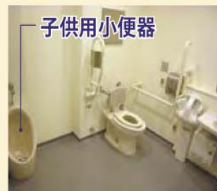
子供用小便器 子ども配慮
