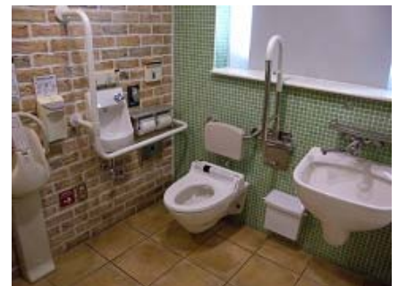
多機能トイレ内部：汚物流し、着替え台、おむつ替えシート、ベビーチェアを設置
