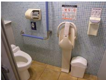
男性トイレ内広めのトイレ： ベビーチェアを設置。扉は引き戸。
